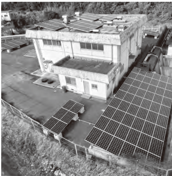
■新松原排水機場（太陽光発電）
