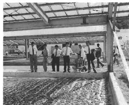
岡垣町浄化センターの汚泥乾燥床
