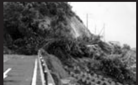
▲ 1982 (昭和 57) 年 7 月、波津～鐘崎間県道での土砂崩れ。数日間通行できない状態だった
