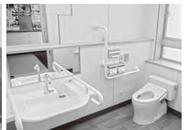
▲岡垣東中学校多目的トイレ
