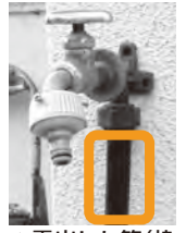
▲露出した管(枠で囲んだ部分)
