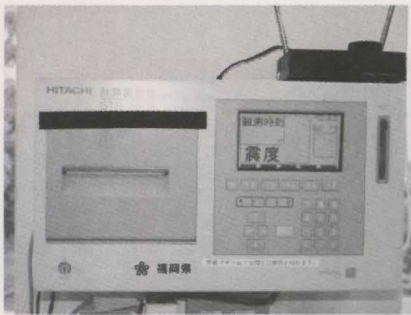
庁舎内に設置されている地震計
