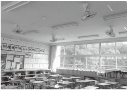
教室に設置された扇風機
