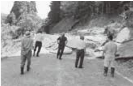
高倉・上畑線の道路法面崩壊現場
