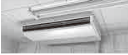
岡垣中学校エアコン
