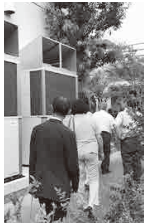
ガス方式のエアコン室外機 (山田小)
